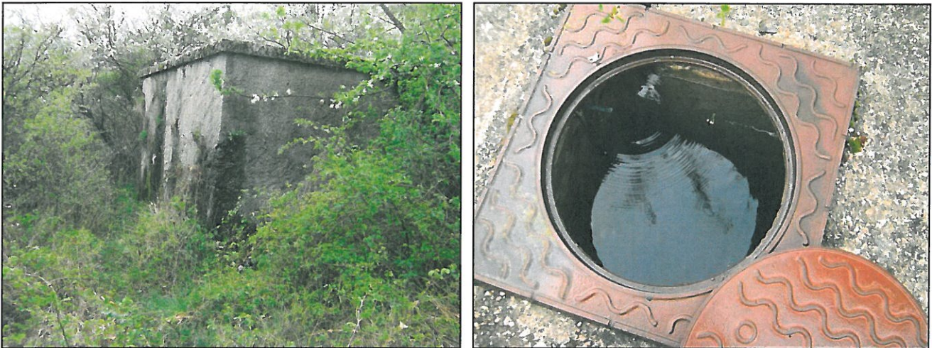
Figure 10 – Réservoir du captage de la source de Pratcoustals (vue extérieure et regard d'accès)
