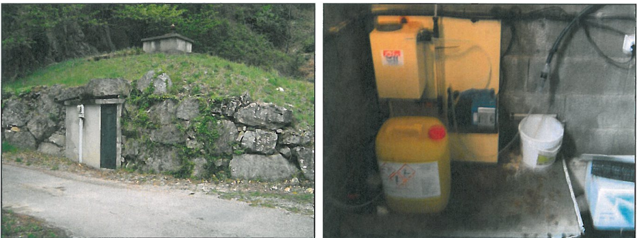
Figure 7 – Réservoir du Mas Quayrol
