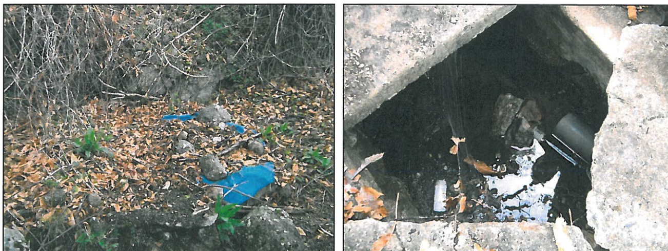
Figure 9 – Captage de la source de Pratcoustals (vues extérieure et intérieure)
